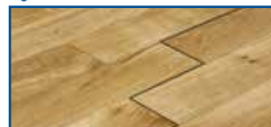
Formation non uniforme des joints en raison du collage des bords
